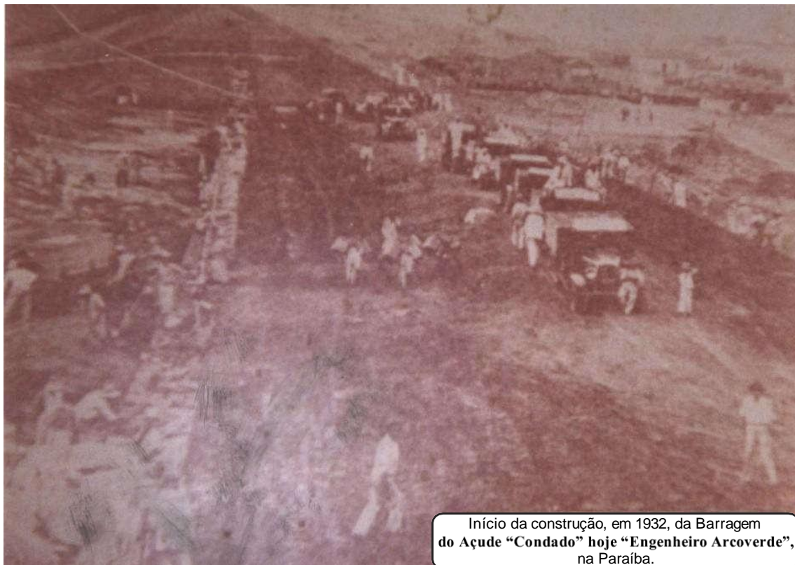
Fundação da barragem, em 1932, vendo-se ao lado algumas casa da Rua Velha.
